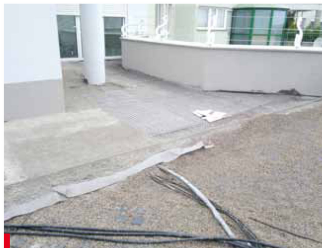
Prace wykonywane przy poszczególnych elementach (taras) i warstwach dachu zielonego w systemie ZinCo FD60
