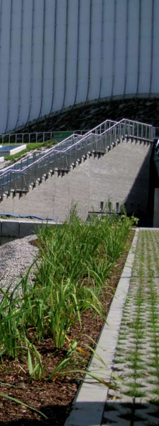
Fot. 1 | Dach zielony Opery Podlaskiej jako przykład dachu systemowego wykonanego w technologii ZinCo
