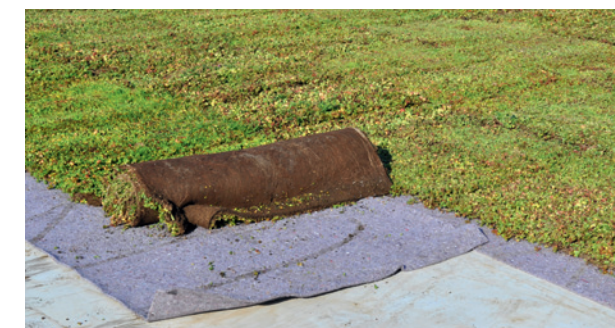
System TUNDRA LIGHT – ekstensywny bardzo lekki ekonomiczny, wyjątkowo łatwy w wykonaniu, doskonałe rozwiązanie na duże powierzchnie i jako najprostsza forma powierzchni biologicznie czynnej na dachu
