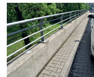
Komunikacja na dachu Rozwiązania drenażowe dla powierzchni na dachu przeznaczonej do ruchu pieszych i kółowego
