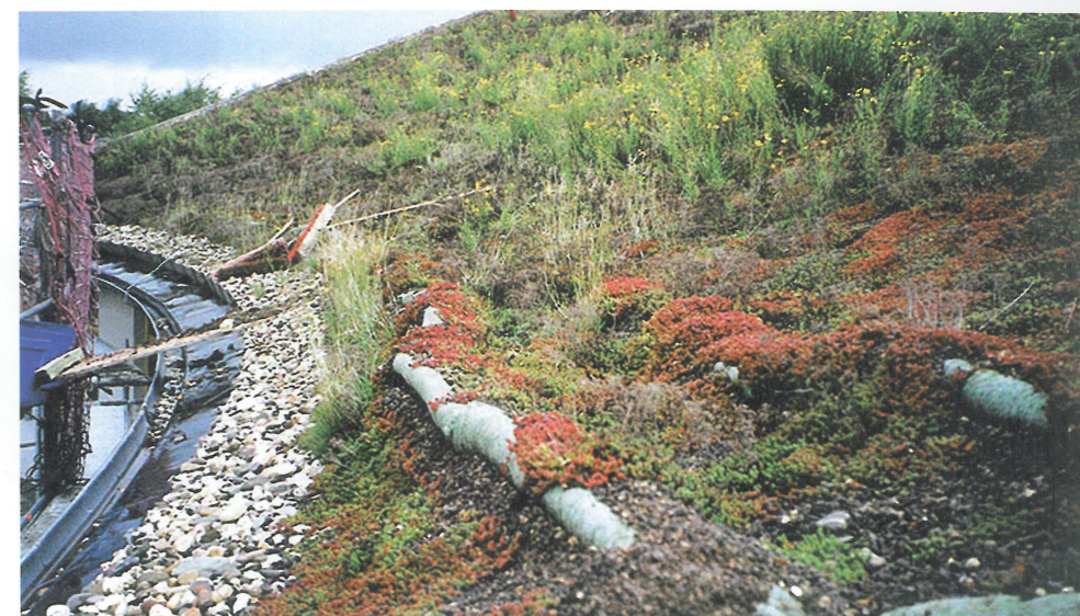
Tu także dachu nie zabezpieczono przed osuwaniem
