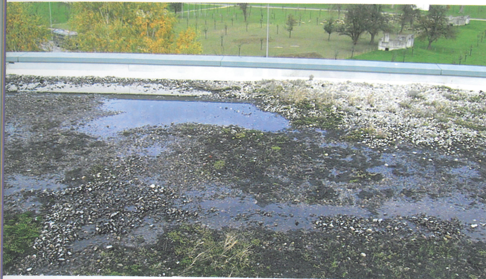
Skutki niewłaściwego odprowadzenia wody
