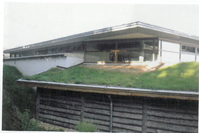
Ze względu na brak wody część zielonego dachu obumarała
