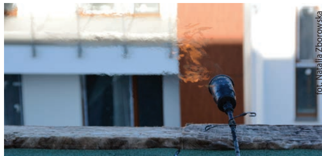
Fot.3. Praca wykonywana na dachu (w tym dachu zielonym) przy użyciu otwartego ognia może stwarzać zagrożenie pożarowe
