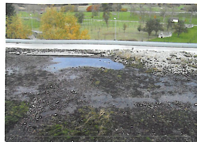
Skutki zastosowania nieodpowiedniego drenażu
