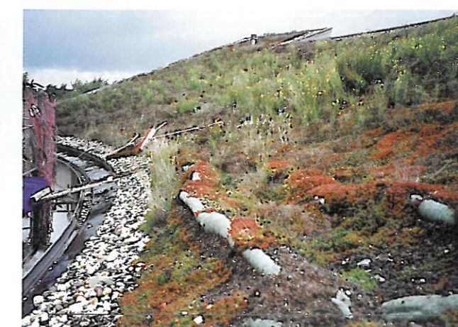
Złe zabezpieczenie przed osuwaniem
